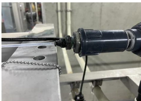
図 1. 漏洩箇所:この部分を中心に漏洩した跡あり
