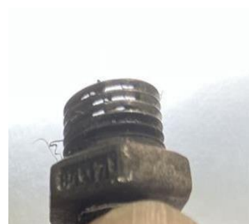
図 4. ねじ込み配管部分孔状況
