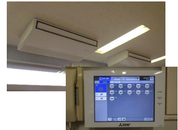
教室のエアコンと集中管理システム
