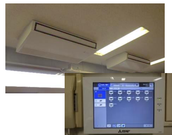
教室のエアコンと集中管理システム
