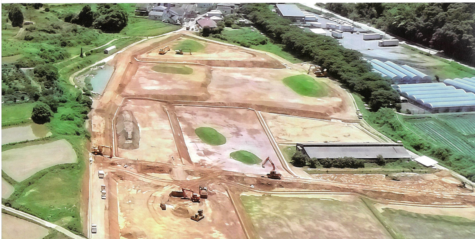
薦野清瀧地区の基盤整備事業。施工前(写真上)と施工中(写真下)。
