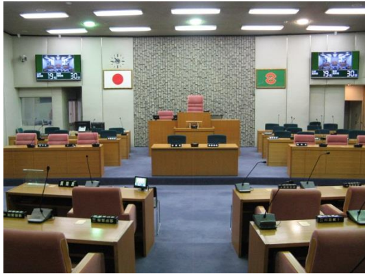
大型液晶モニター（70インチ）を正面に2台、後方に1台設置
