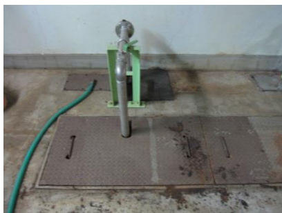
脱窒素槽攪拌用窒素ガス供給管①
