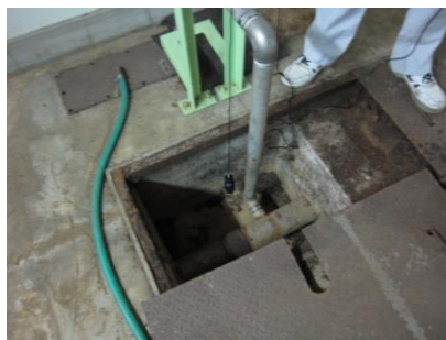
脱窒素槽攪拌用窒素ガス供給管②
