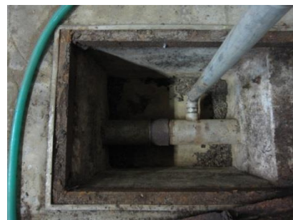
脱窒素槽攪拌用窒素ガス供給管③
