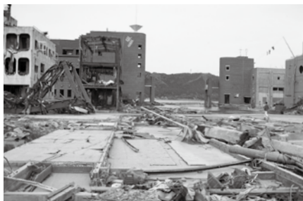
▲骨組みだけになったビルが津波の脅威を 物語る(宮城県内)
