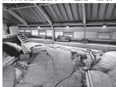
阪神淡路大震災での道路の崩壊
