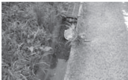
蓋のない側溝に落ちたゴミ、掃除も重労働
