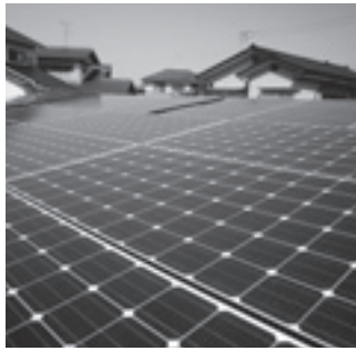
個人住宅以外の太陽光パネル
