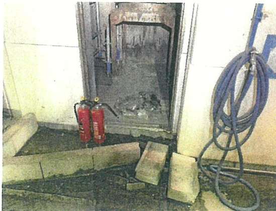
場内他設備異常なし
