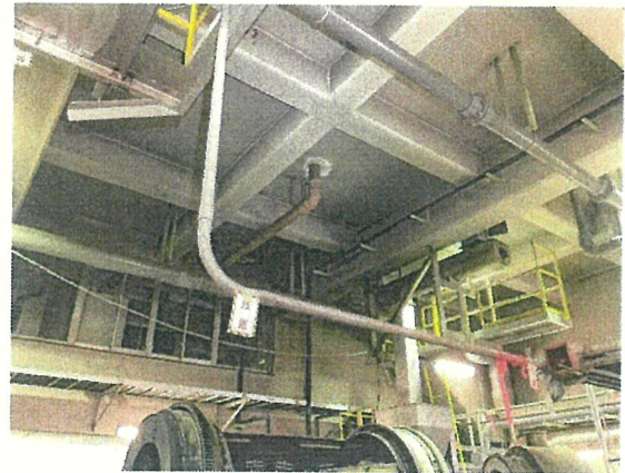
場内他設備異常なし
