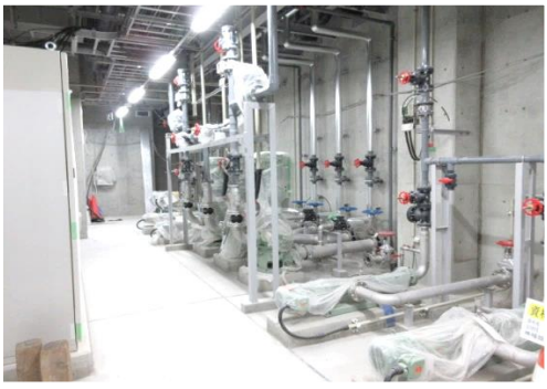
1階 (I Z循環ポンプ)
