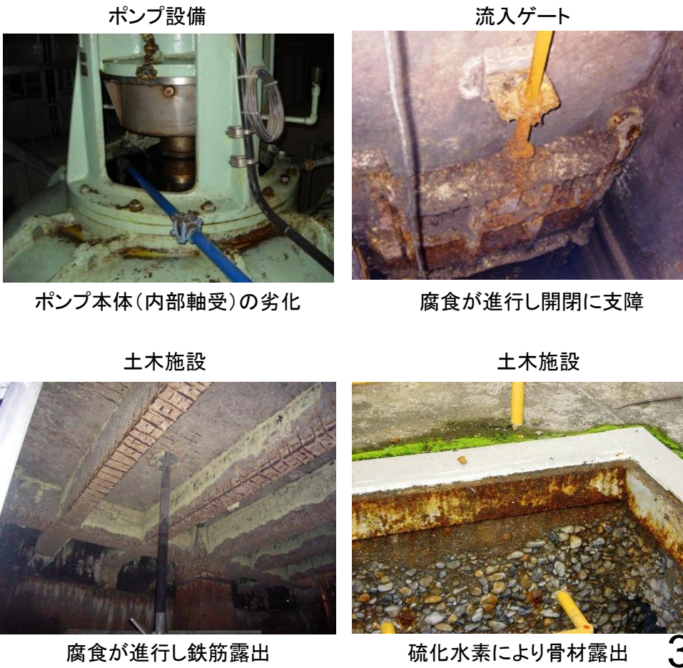
処理場設備の老朽化の例
