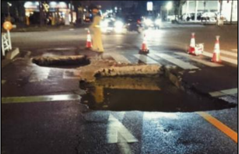
● 管路施設に起因した陥没事故
