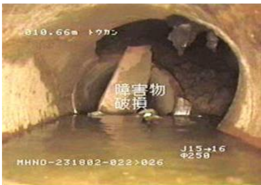
破損した管路
