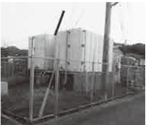
小野里団地（米多比）の簡易水道施設
