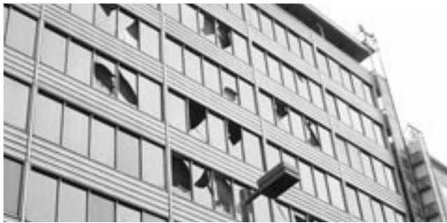
記憶に新しい福岡西方沖地震の被害
